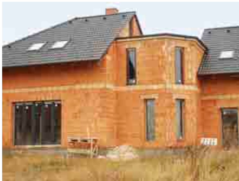
Typická kvalita zdiva z tvárnic v tuzemsku, porušení principů vazby, zpracování poškozených tvarovek, nerovnoměrnost rozměrů spár atd...
